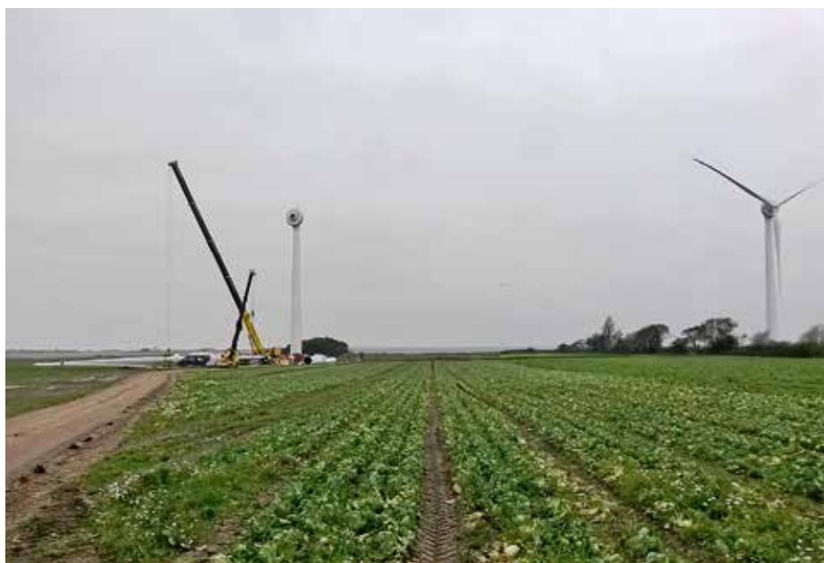
De to 900 kW EWT-møller under rejsningen på Tåsinge sidst på efteråret 2017. (Foto EWT)
